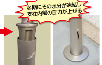
支柱の上部や下部が破損してしまいます。
